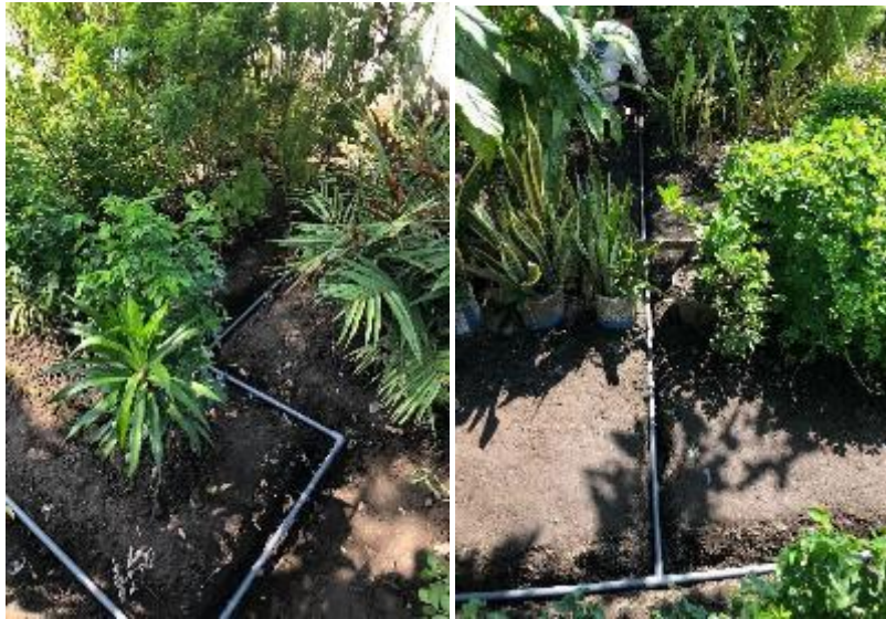
Gambar 1. Saluran Pipa Air
